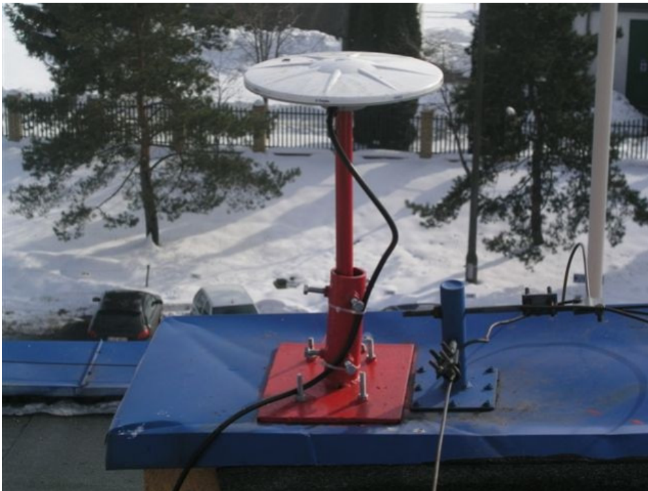
Rys. 6. Antena GPS na dachu budynku Cechowni (nad siedzibą Działu Mierniczo-Geologicznego kopalni LW „Bogdanka”) Fig. 6. The GPS antenna on the roof guildhall (based on Department of surveying - Geological Mine LW „Bogdanka”)
