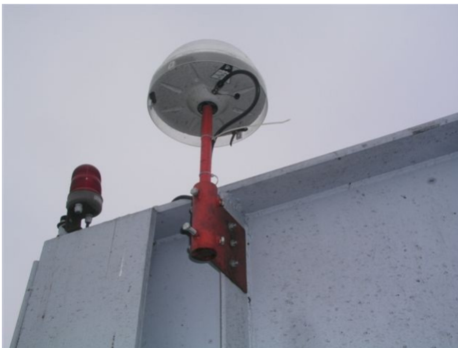
Rys. 5. Sposób zamocowania anteny GPS na szczycie wieży szybu S 1.3, kopalni LW „Bogdanka” Fig. 5. The mounting of GPS antenna on top of the tower shaft S 1.3, mine LW „Bogdanka”
